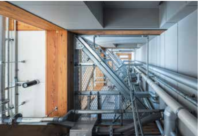
4層吹き抜けのエコシャフト見上げ。各住戸の配管を集約し、維持管理に配慮している。また換気・採光を取り入れる環境装置の役目も果たす。
